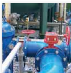
■ Tratamiento del agua
